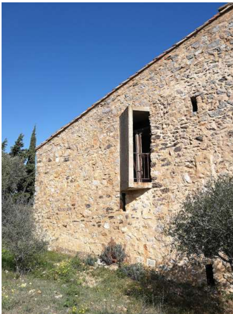
Figure 139 : Déflecteur protégeant des vents dominants une ouverture à l'ouest de la maison des Perdrigals conçue par M. Gerber. (photo Clément Gaillard, le 16 octobre 2019)
